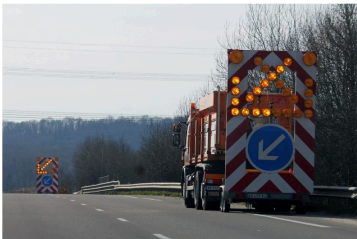
Certaines sorties de l'A63 seront fermées dans la soirée de lundi 3 et mardi 4 janvier 2020 pour des travaux. (©Illustration/Fotolia)
