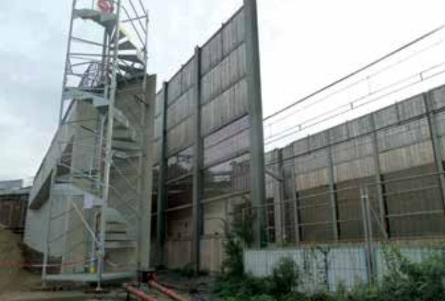
Écrans protecteurs le long des voies ferrées.
